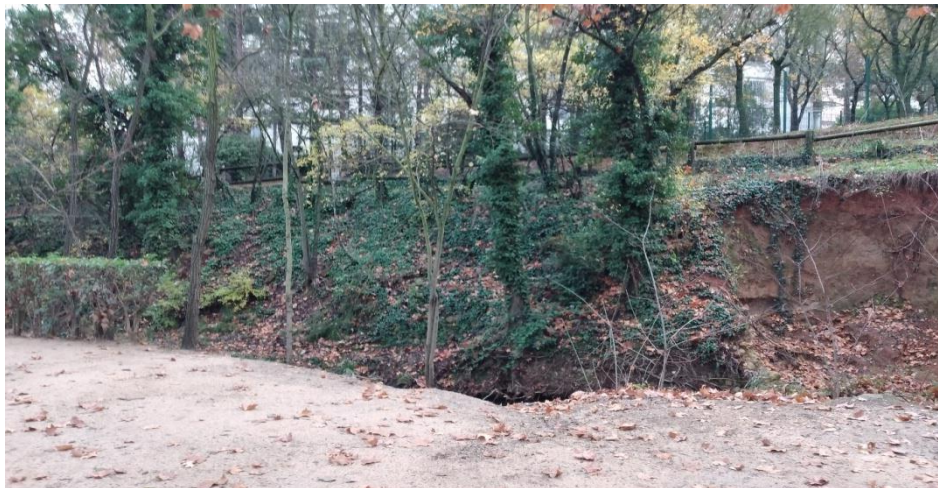
Nouvel effondrement sur la rive droite de la Torse
