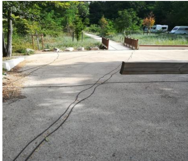
Câbles électriques au sol sans protection
