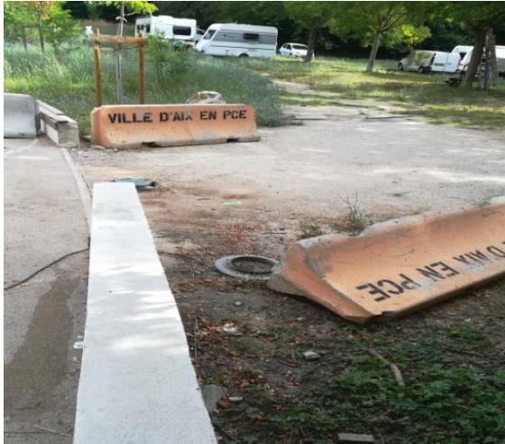
Glissières en Béton Armé déplacées Borne d'accès abaissée et détériorée
