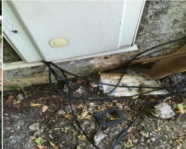
Branchement sauvage au compteur EDF
